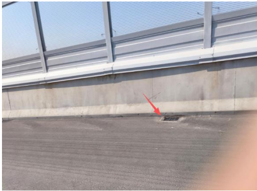
桥面径流收集口
